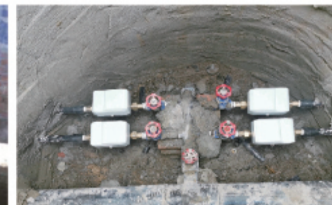
陕西城乡居民供水计量项目
