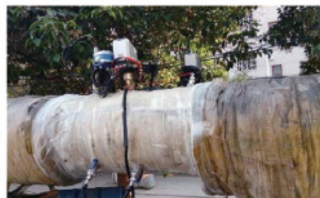
石家庄供热管网监测工程
