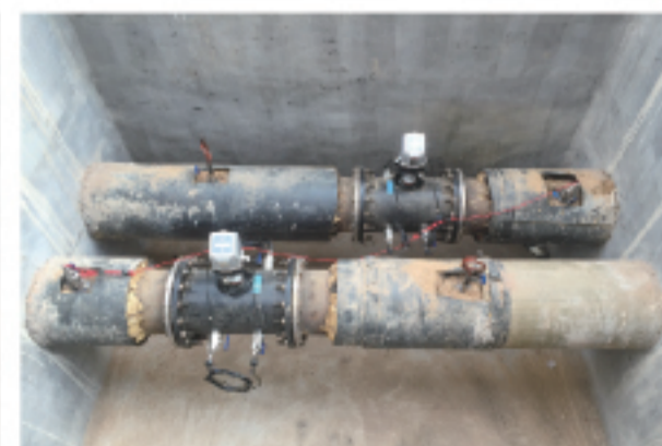
济南供热管网监测项目
